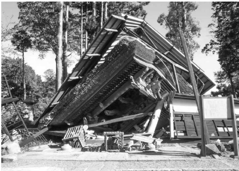
倒壊した関東最古の寺院の鹿野山神野寺の表門
