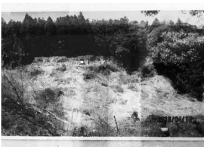
図表2 現在の埋立地の状況 (森林伐採により崩壊が心配される崖の写真)
