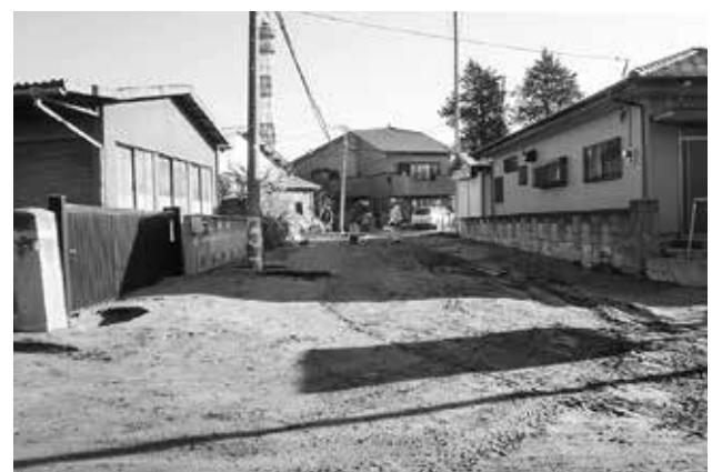
図表10 利根川右岸(下川岸地区)の液状化被害(写真)
