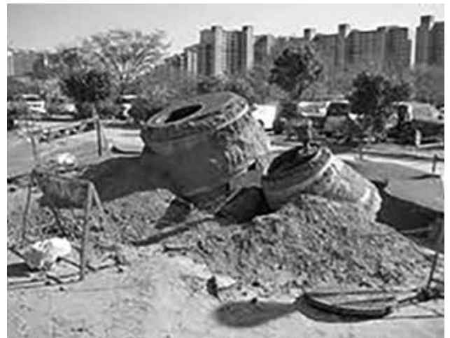
図表7 液状化で浮き出たマンホール（写真）
