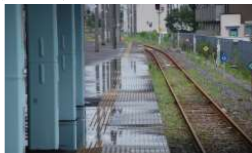
勾配がないためできた水たまり（駅ホーム）
